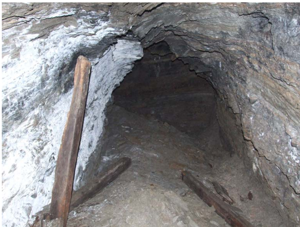
Sl. 58 Profil središnjeg dijela starog tunela KTK sa ostacima građe (Photo: Arhiv Fondacije 26. oktobar 2006)
